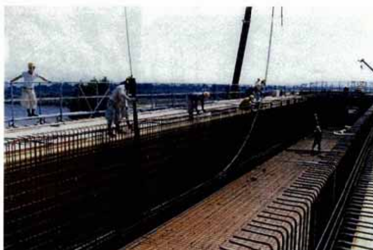
写真 1-10 ケーブルの配置状況
