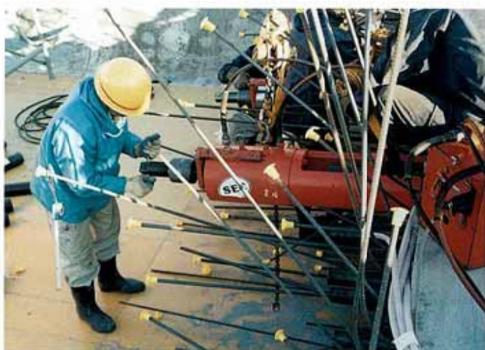
写真 2-1 緊張ジャッキ
